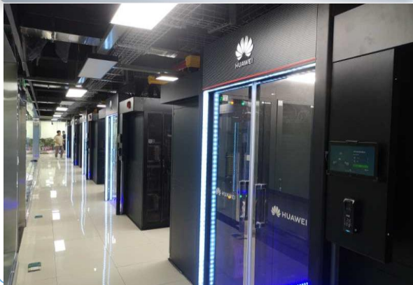
德阳公安数据中心机房
