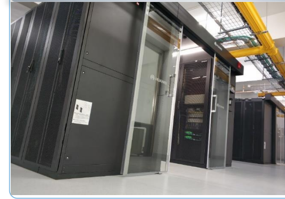
绵竹公安数据中心机房
