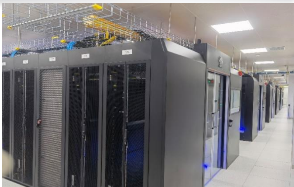
华西医院数据中心
