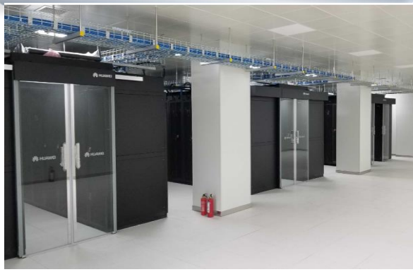
西藏气象局数据中心机房
