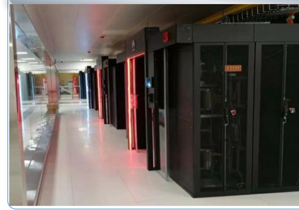
四川广安公安数据中心
