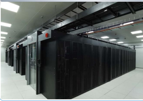
绵阳公安数据中心
