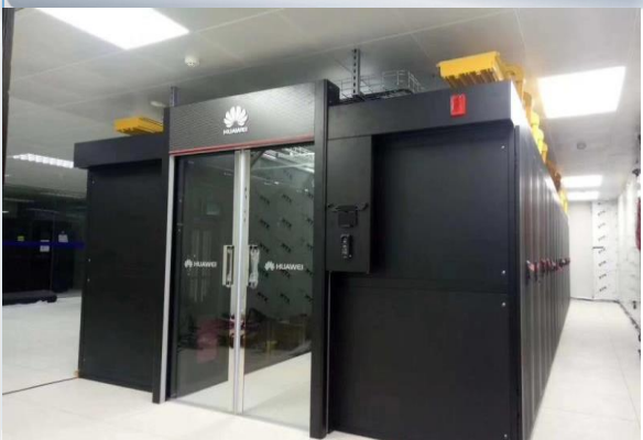
成都信息工程大学数据中心
