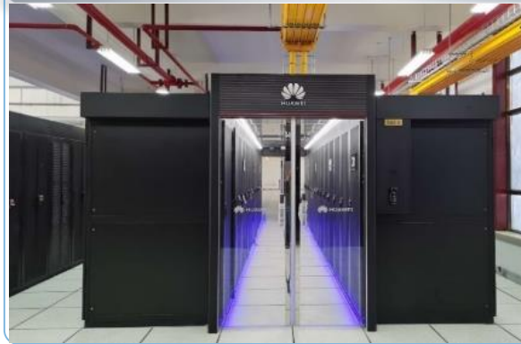
成都某单位数据中心
