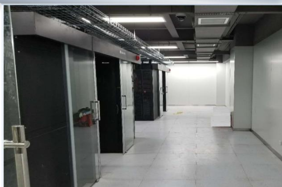
江安政务中心机房
