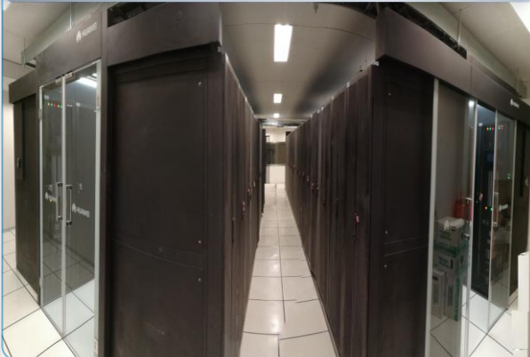
华西第二医院数据中心
