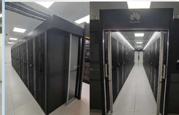
彭州人民医院数据中心
